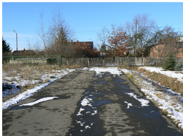
Ilustracja 33. Brakujący odcinek drogi serwisowej w Cmolasie
